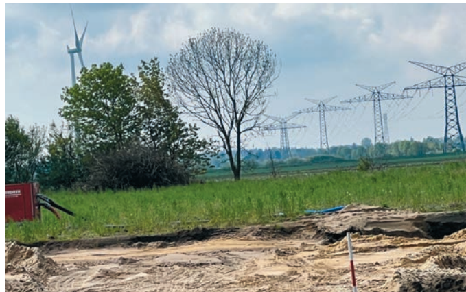
Von der Baustelle in Seth ein Blick über die Grenze, wo die auf deutscher Seite stehenden Hochspannungsmasten zu sehen sind BRIGITTA LASSEN
