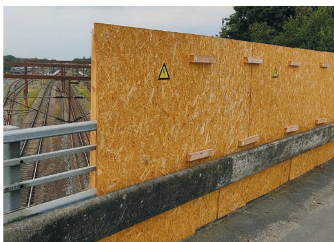
Die Holzplatten auf der Eisenbahnüberführung in Tingleff dienen dem Schutz von Passantinnen und Passanten. KJT
